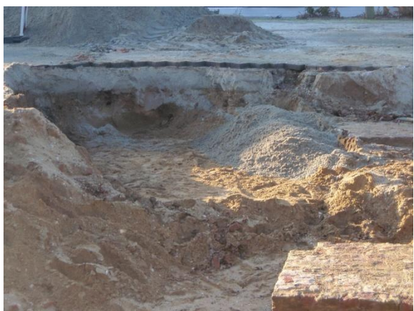
Foto 5: Zicht op putwand 2 (W2) welke niet voldoet aan de achtergrondwaarde voor minerale olie.
