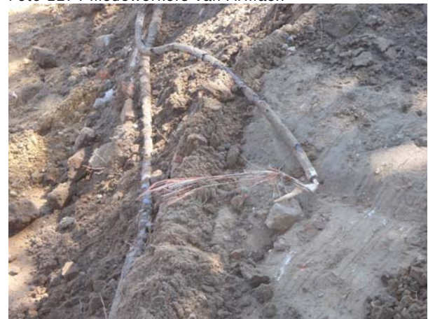
Foto 14: Oude kabels binnen het terrein
