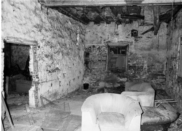
Afbeelding 67 Achterbouw inwendig vóór de instorting in juli 2002
