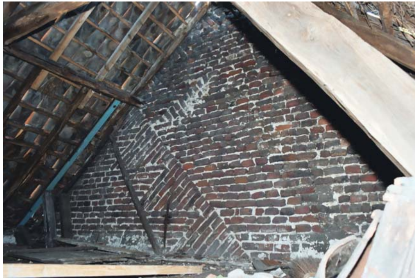
Afbeelding 47 Bouwsporen ophoging voorgebouw
