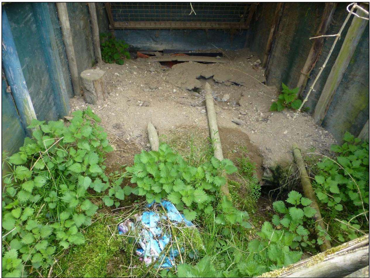
Figuur 6: Rechtsonder in de foto is de pijp te zien. Het vloertje is ter hoogte van de pijp ingezakt.
