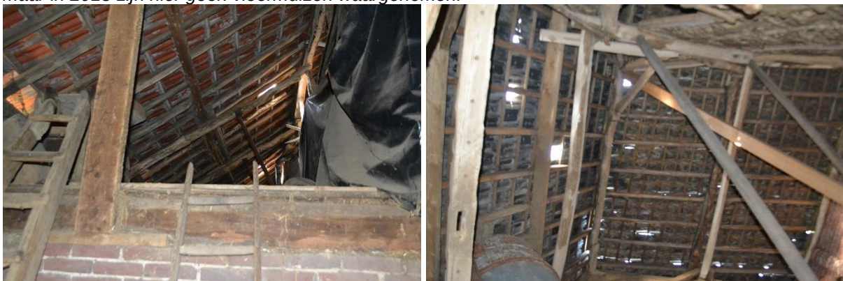
Figuur 3.2 Situatie dak bedrijfswoning met inpandige koestal. Zichtbaar zijn de gaten in het dak vanwege ontbrekende en/of scheefliggende dakpannen. Tevens zijn zichtbaar de steunbalken en panlatten. Het pand is alleen geschikt als tijdelijk onderkomen voor vleermuizen als paar- en/of zomerverblijf.
