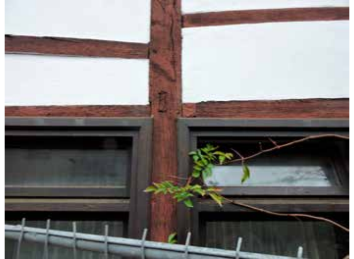
6. De regels annex bovendorpels van de ramen zijn secundair aangebracht en niet getoogd
