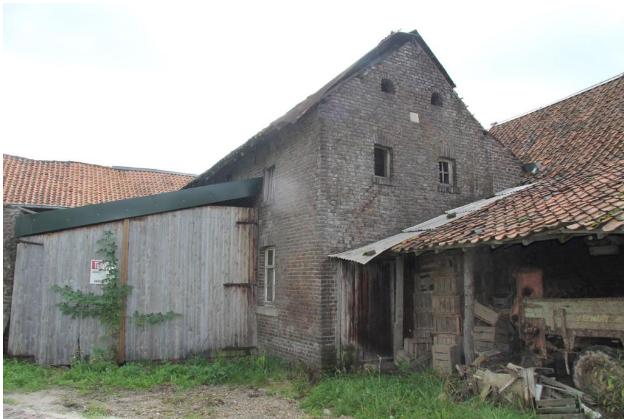
Afb. 54 De voormalige boerderij aan de Leutherhoekweg te Maasband verkeert in slechte staat
