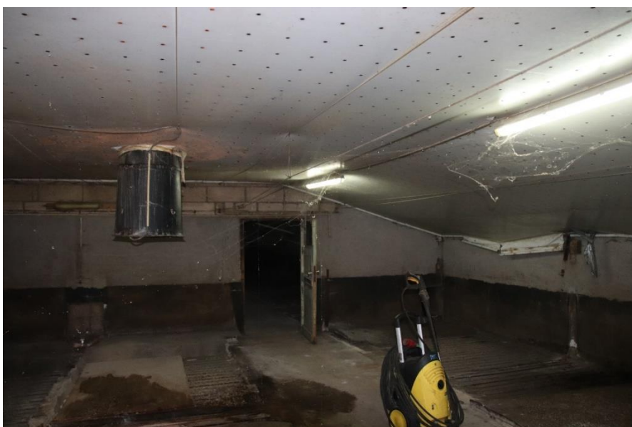
Foto 4: Grote aantallen spinnenrag maken het gebouw ongebruiksvriendelijk voor vleermuizen
