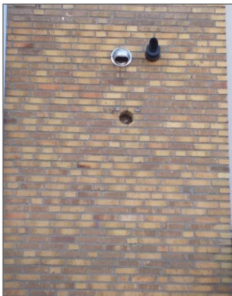
Figuur 3.2 Gat in muur van Baesweilerstraat.
