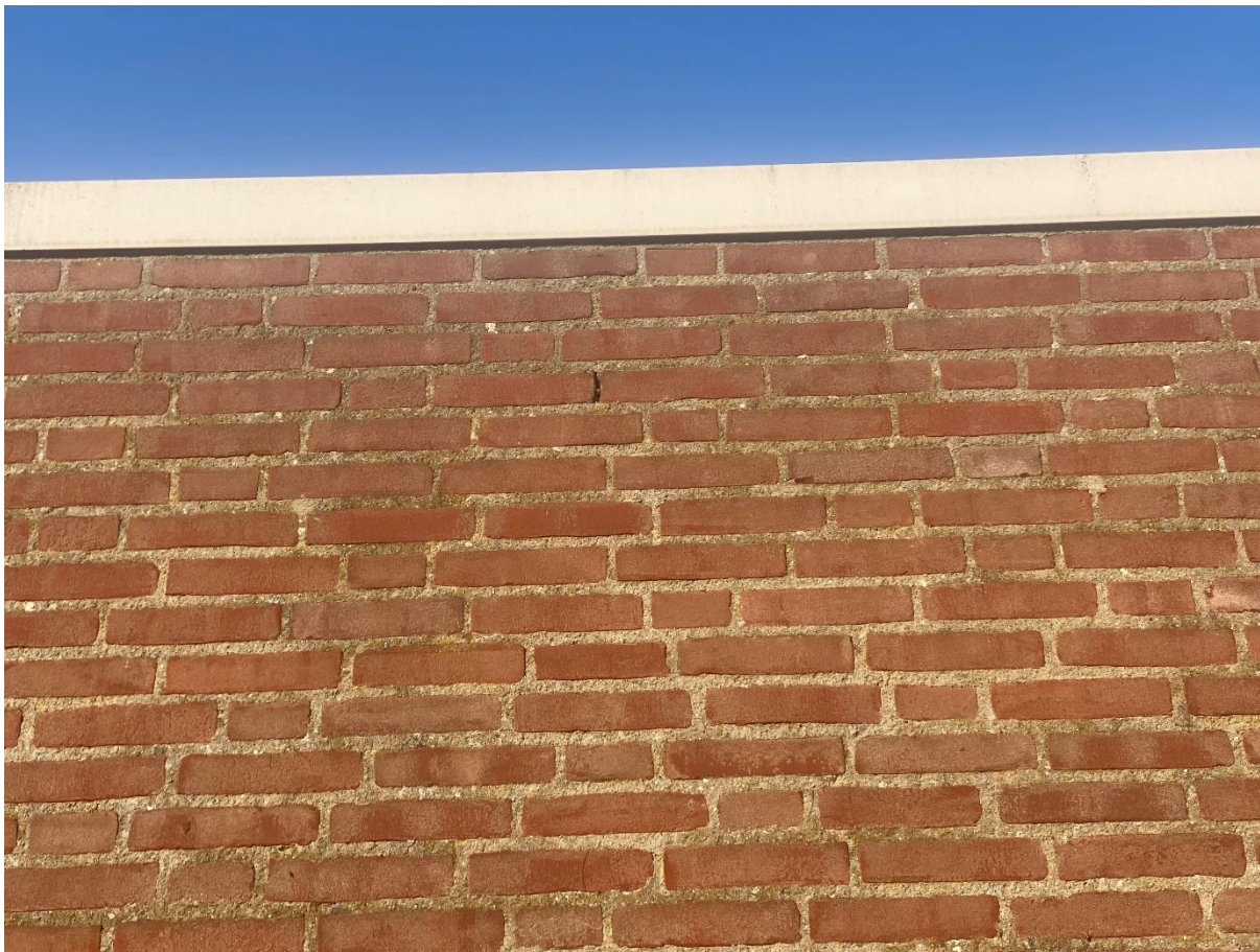
Foto 3: Spinnenrag in de open stootvoeg en de daktrim zit zeer strak gemonteerd zodat er geen ruimte onder zit.
