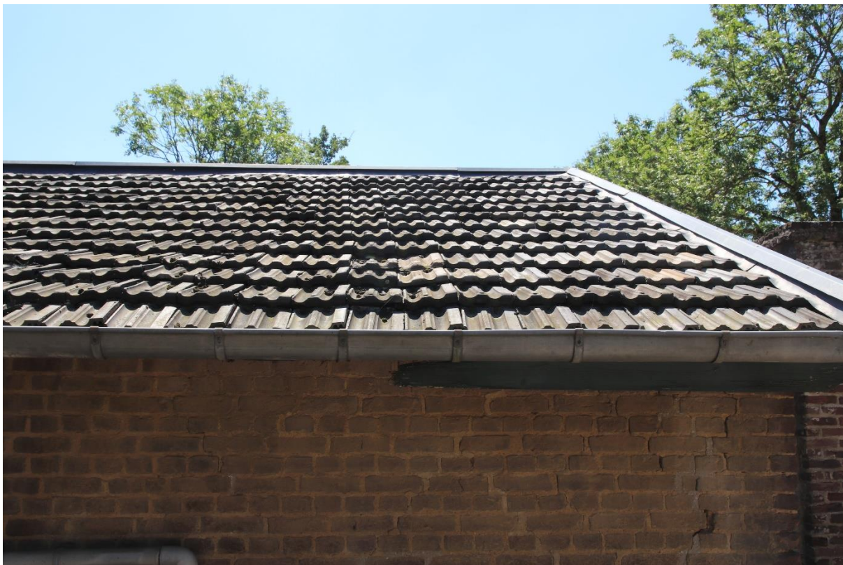
Foto 3: De dakpandaken bieden geen broedplekken voor gebouwbewonende soorten: omdat ze plat zijn, maar vooral omdat er geen dakplaat constructie aanwezig is, waar soorten onder kunnen kruipen
