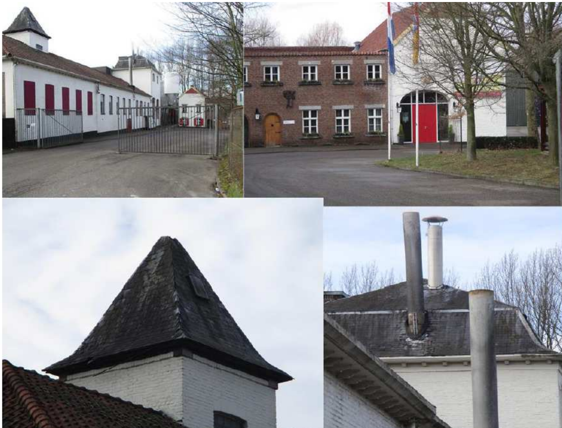
Figuur 14: Alfa Bierbrouwerij (links- en rechtsboven), met zichtbaar verval aan de daken (links- en rechtsonder).
