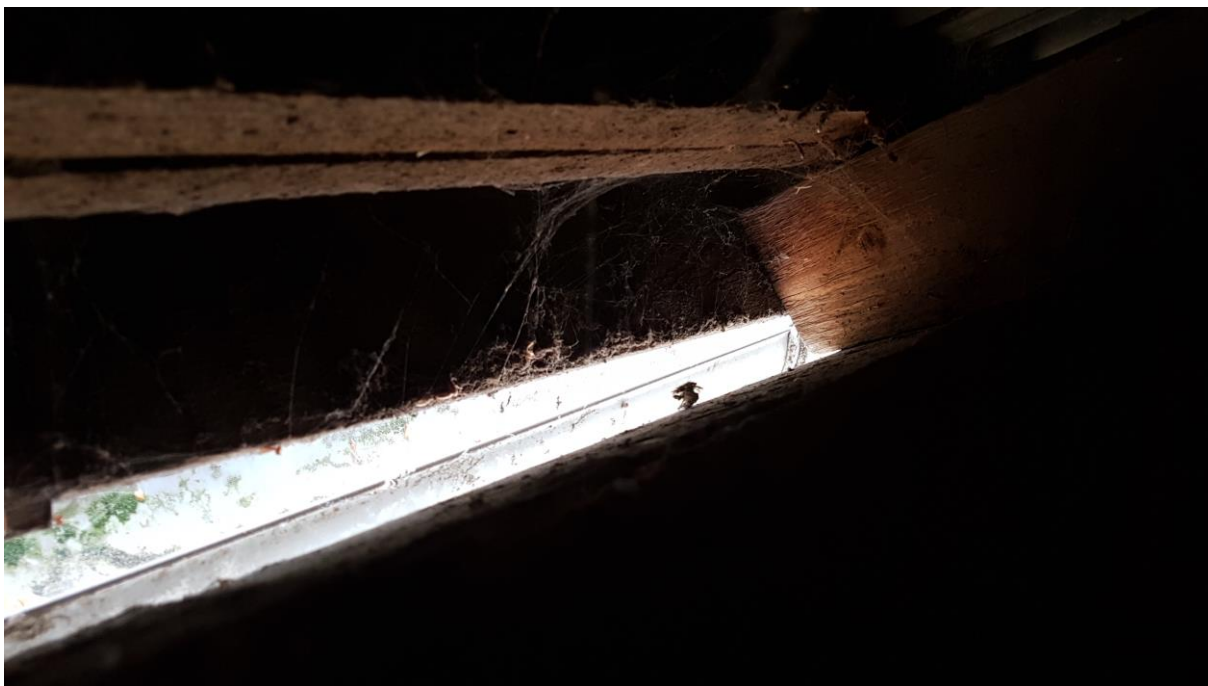
Foto 13: Opening tussen de muur en het dak in de paardenstal.
