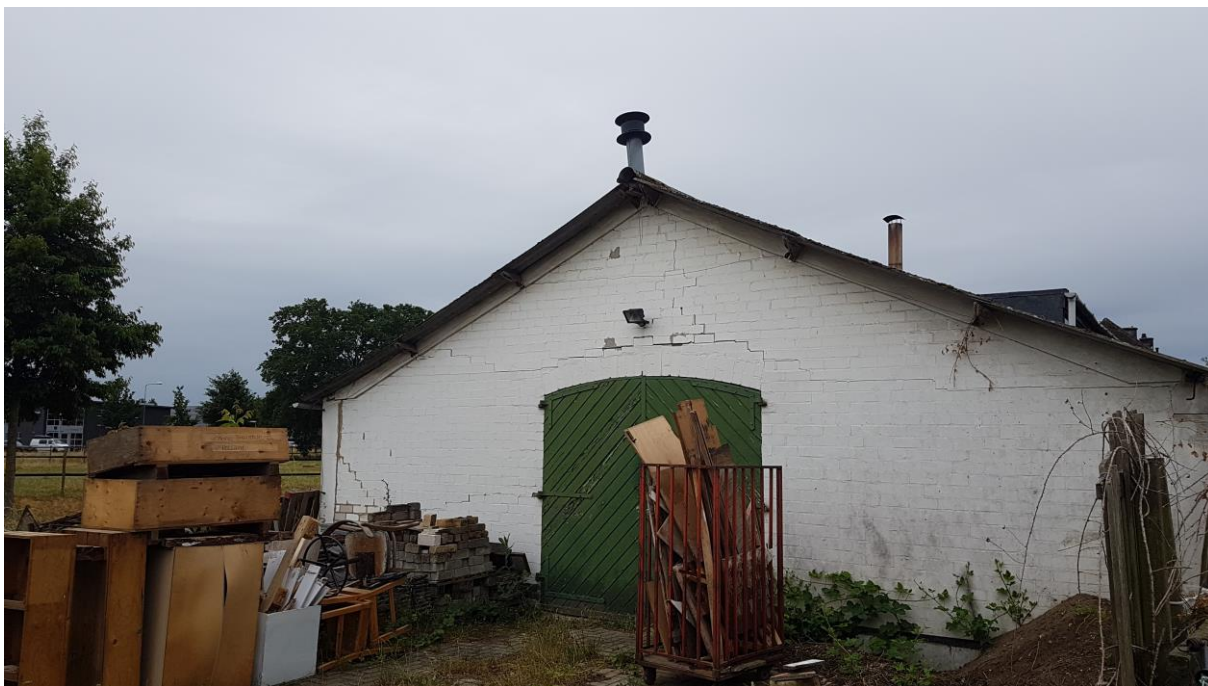
Foto 5: De oostelijke kopse kant van de bedrijfsloods met scheuren in de gevel en rommelhoekje van stenen en hout.
