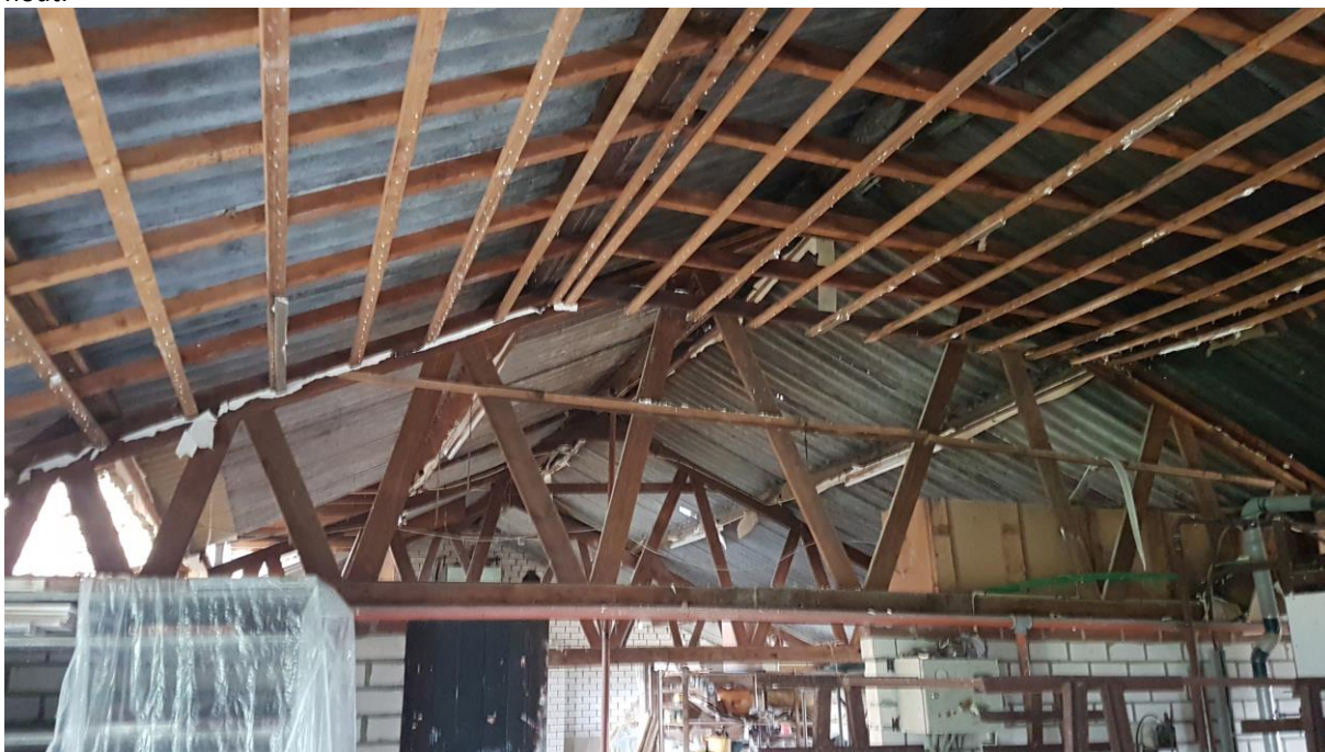
Foto 6: Binnenkant van de bedrijfsloods. Het dakbeschot is reeds verwijderd en de asbest dakplaten zijn zichtbaar.
