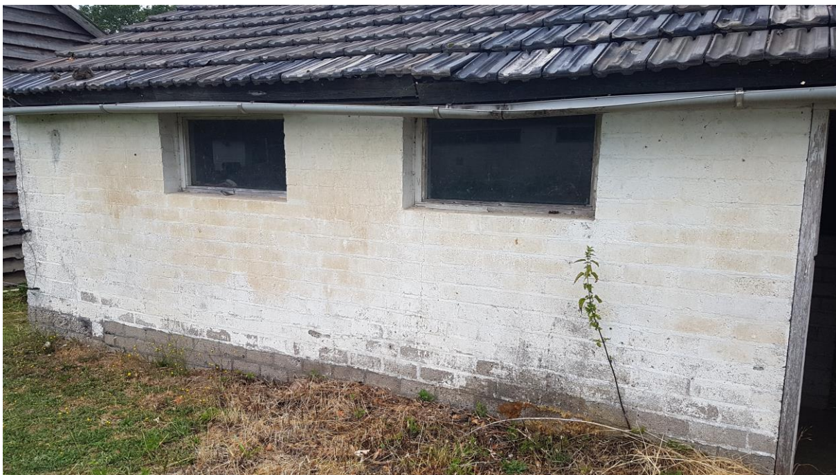
Foto 9: De voorkant van de paardenstal (westkant) met links op het dak de oude vogelnesten gevonden onder de dakpannen.
