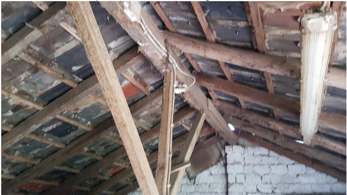
Foto 12: Het dak van de paardenstal heeft geen dakbeschot.
