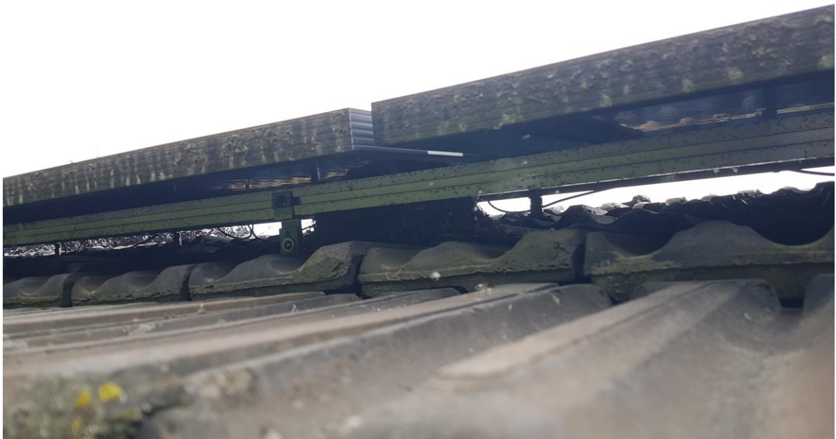
Foto 16: Vogelnest onder de zonnepanelen op het dak van de kapschuur.
