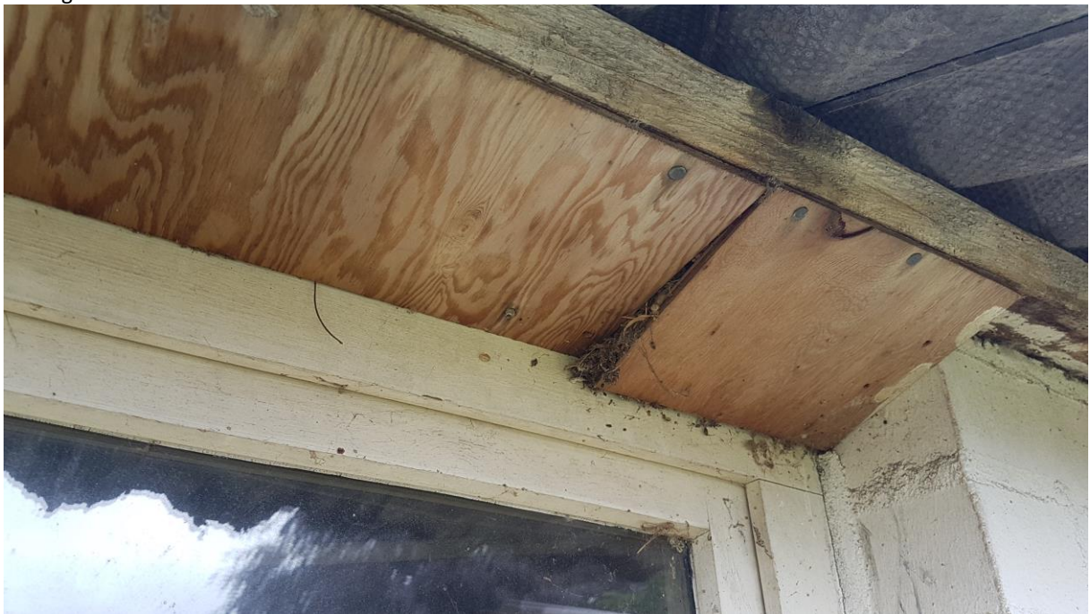
Foto 8: Nestmateriaal boven het houten raamkozijn aan de achterkant van de bedrijfsloods.
