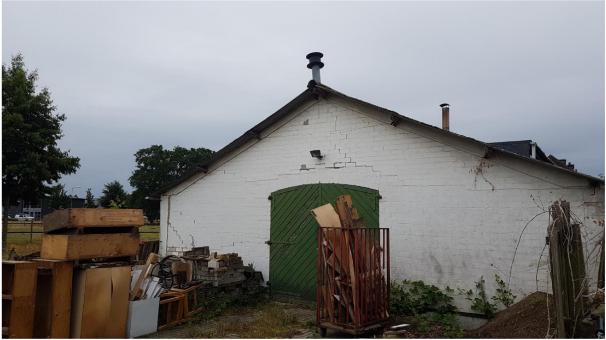
Foto 5: De oostelijke kopse kant van de bedrijfsloods met scheuren in de gevel en rommelhoekje van stenen en hout.
