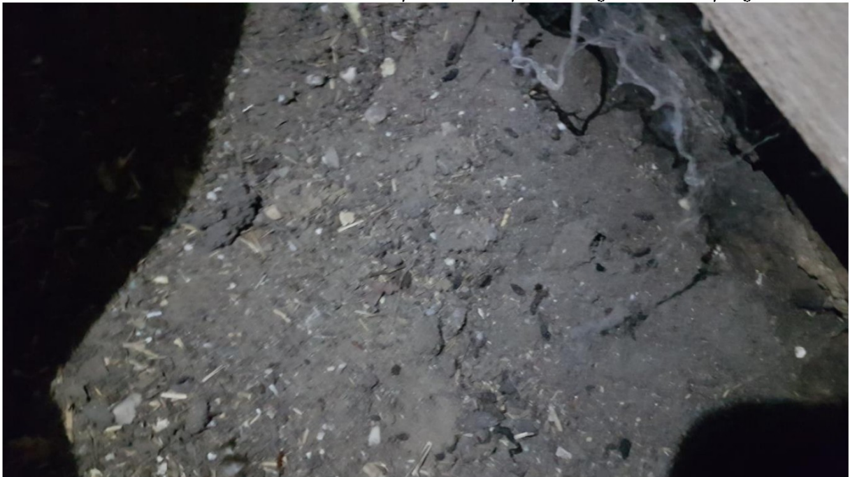
Foto 18: Muizenfecaliën op de grond in de kapschuur.
