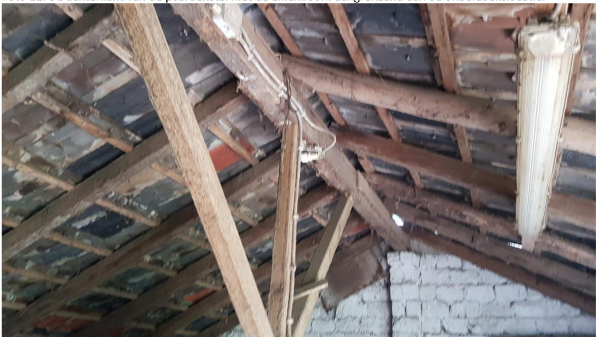
Foto 12: Het dak van de paardenstal heeft geen dakbeschot.
