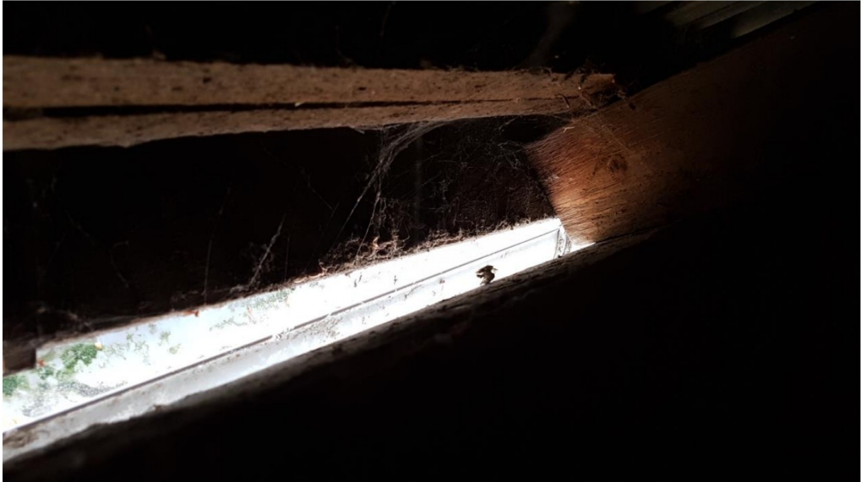
Foto 13: Opening tussen de muur en het dak in de paardenstal.
