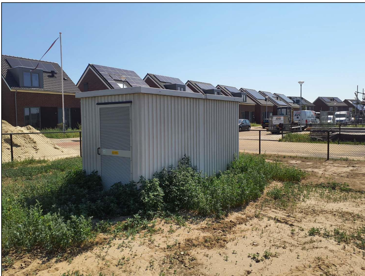
Afb.3 – Het transformatorhuis en hekwerk binnen het opsporingsgebied.
