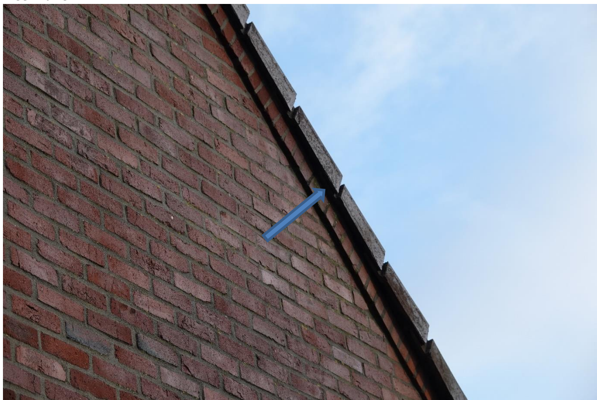
Foto 2: enkele smalle openingen onder de dakpannen van de kopgevels kunnen toegang bieden tot de achter liggende delen voor vleermuizen
