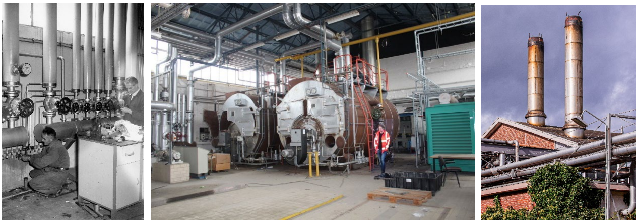
Figuur 4 gasinstallaties en rookgasafvoer Ketelhuis circa 1970 (links) en 2021 (rechts)
