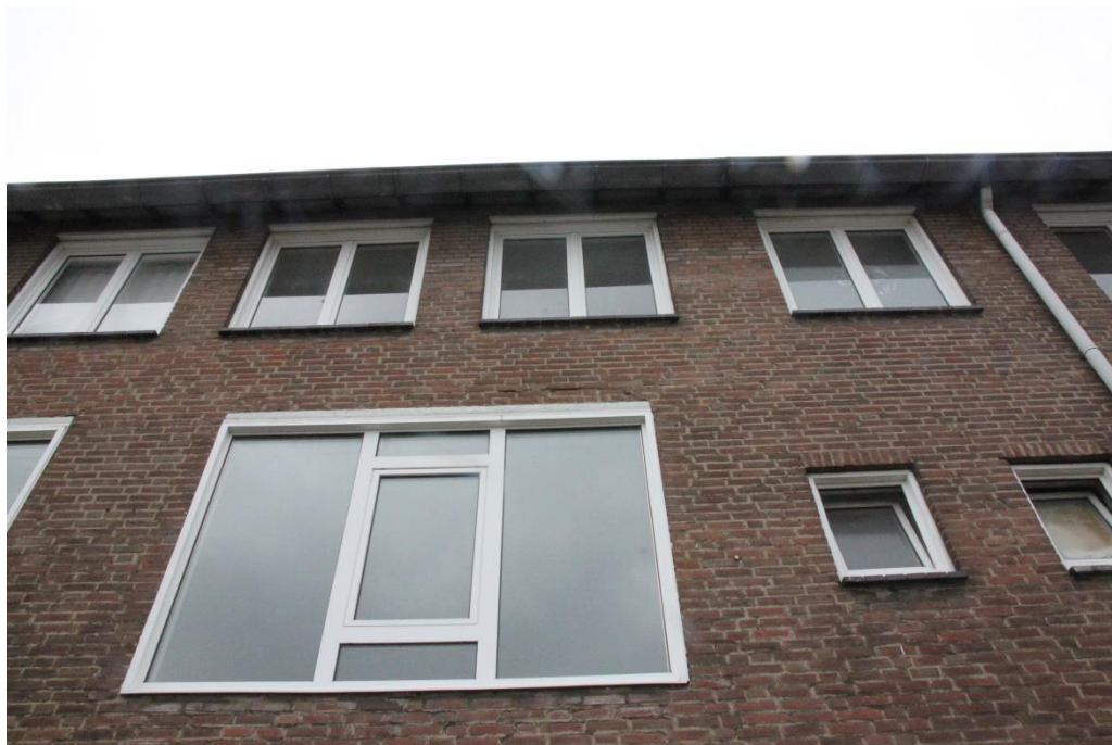
Foto 2: open stootvoegen ontbreken, net als andere openingen in de muren, onder dakpannen en bekistingen
