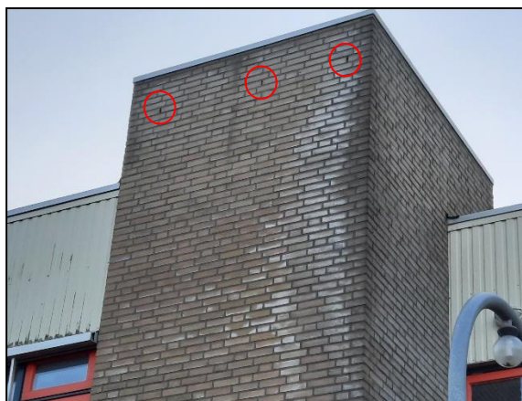
Figuur 15. Stootvoegen in hoogbouw (rood omcirkeld), kijkrichting zuiden.
