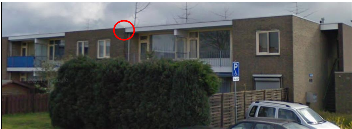
Figuur 3. Aangetroffen zomerverblijfplaats achter boeiboord.
