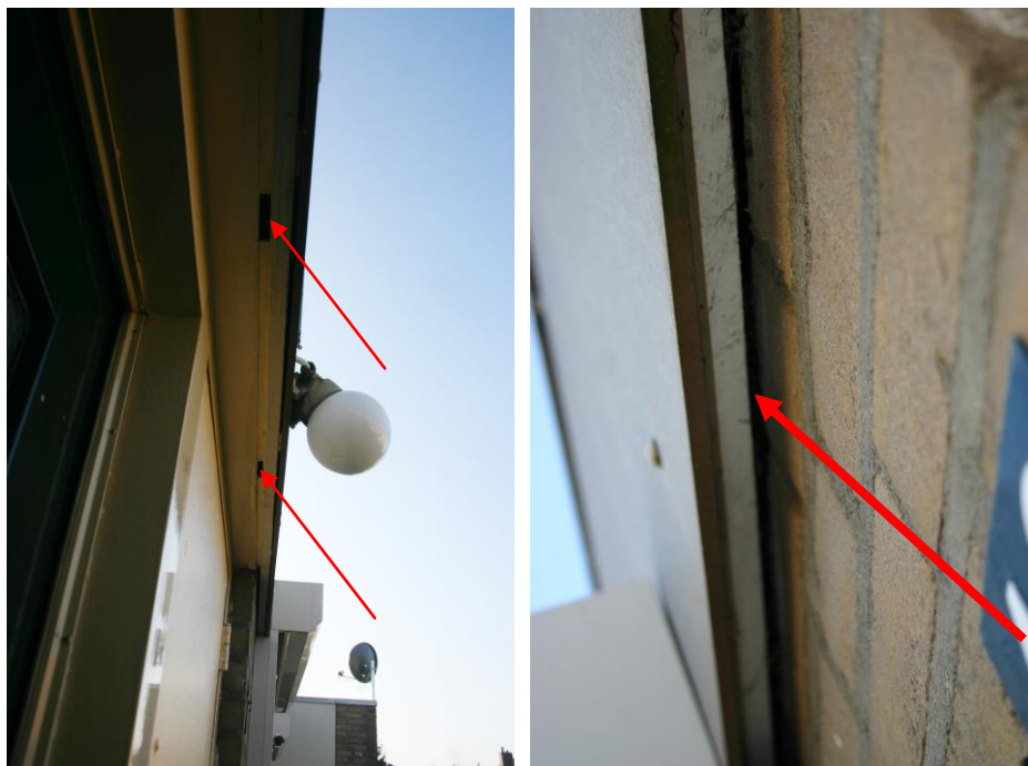
Figuur 4. De trespa boeiboorden tegen de type 1 woningen hebben openingen en kieren (rode pijlen) die vleermuizen toegang kunnen geven tot de achterliggende holte.
