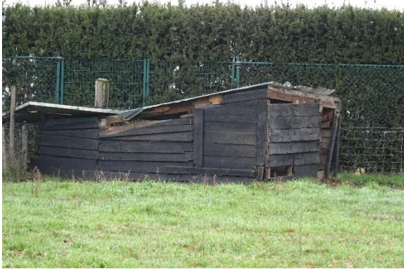
Afbeelding 5: Bestaande te slopen vervallen schuurtje/ schuilstal op de kavel. Bron: R.J.L. Bijvelds 10-12-2020
