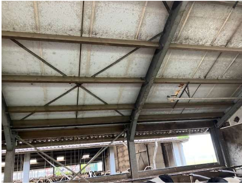
• Afbeelding 25: Onderzijde dak stal 1, sandwich panelen
