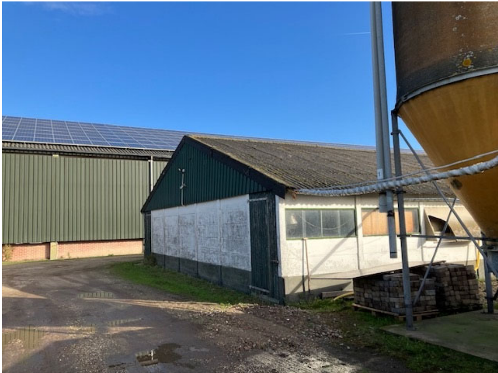
• Afbeelding 5: Te slopen stallen
