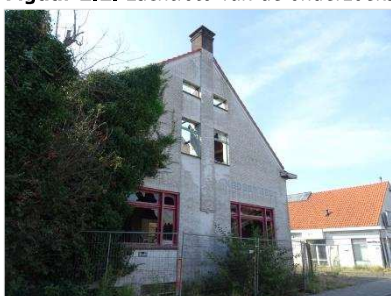
Figuur 2.3. Uitgebrand bedrijfspand aan noordzijde onderzoekslocatie.
