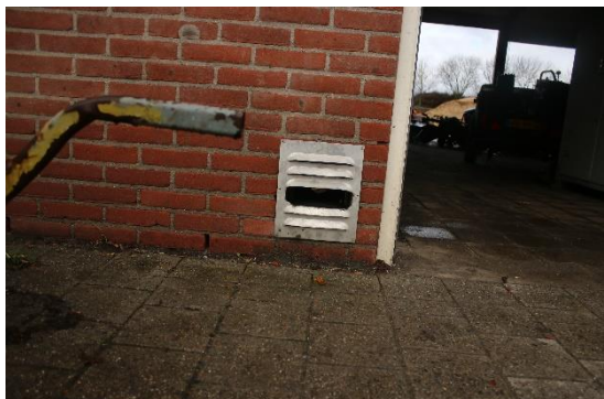
Figuur 3.11: Gat in ventilatiooster van gebouw 1, waardoor deze geschikt is voor de steenmarter.
