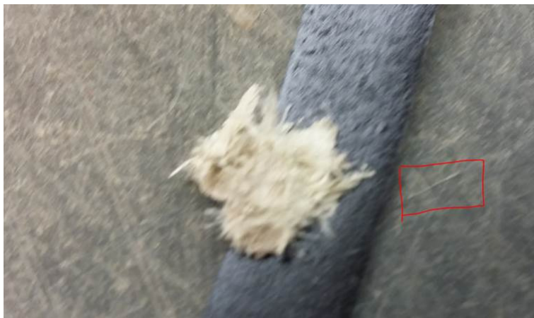
Foto van het aangetroffen asbestverdachte materiaal in mengmonster M.M.6 (op zwarte plakband)
