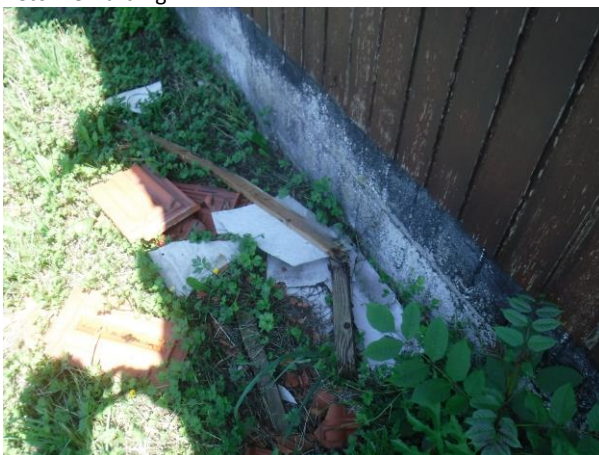
Foto 23 Aangetroffen eterniet spot
