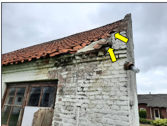
Figuur 14. Voorbeeld van gaten en kieren in bebouwing.
