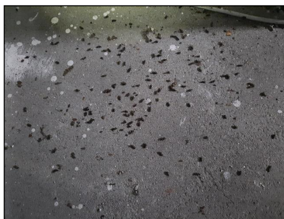
Figuur 17. Uitwerpselen van vleermuizen op de bovenverdieping van de voormalige woonboerderij.
