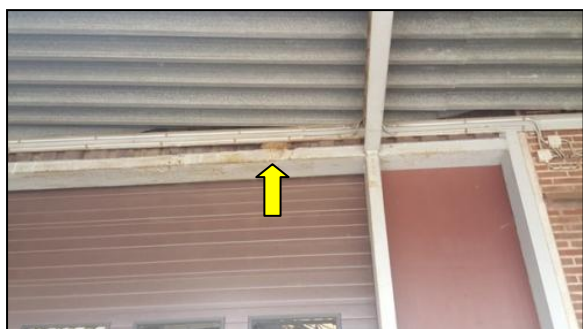
Figuur 10. Vermoedelijk huismussennest aan de zuidzijde van het bedrijfspand.
