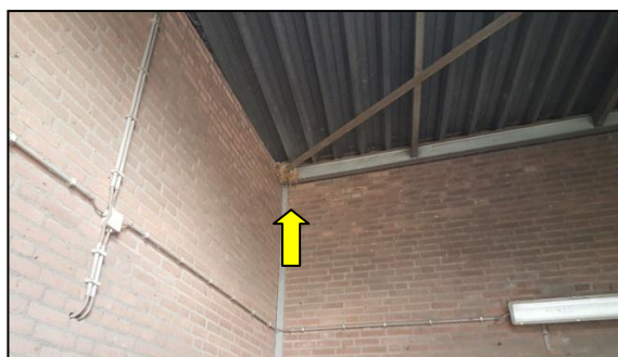
Figuur 11. Vermoedelijk huismussennest aan de zuidzijde van het bedrijfspand.
