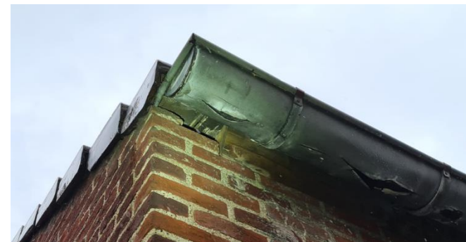
Figuur 12: Mogelijk gierzwaluwnest achter kier tussen dakoverstek en gevel, in de noordoosthoek van het gebouw
