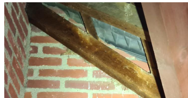
Figuur 13: Mogelijk gierzwaluwnest tussen dakoverstek en houten gelvelbalken, in de oostzijde van het gebouw
