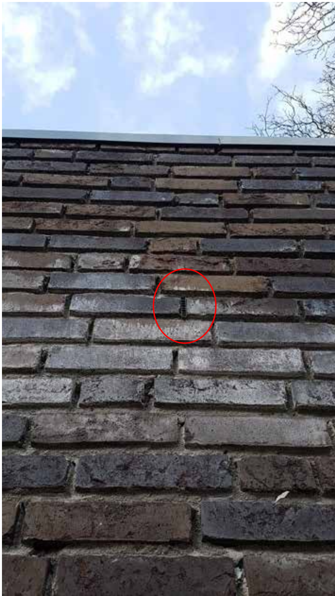
Foto 14: in de openstootvoegen van de gedeelde muur zitten roostertjes.
