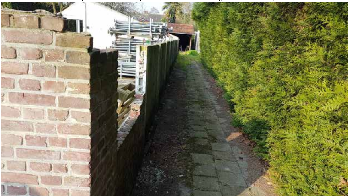
Foto 7: de baksteen muurdelen van de stenen kapschuur zijn steens en hebben geen spouw.
