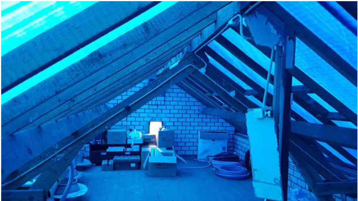
Foto 10: het zeil licht over de nok van het dak. Hier zijn geen geschikte verblijfplaatsen, het zeil warmt te snel op en koelt te snel af.
