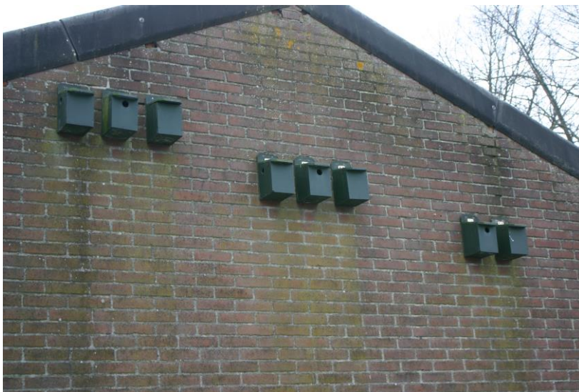
Figuur 4.4.1. Aan de noordwestgevel van de zuidelijke kapschuur bevinden zich acht (ter compensatie opgehangen) huismusnestenkasten.
