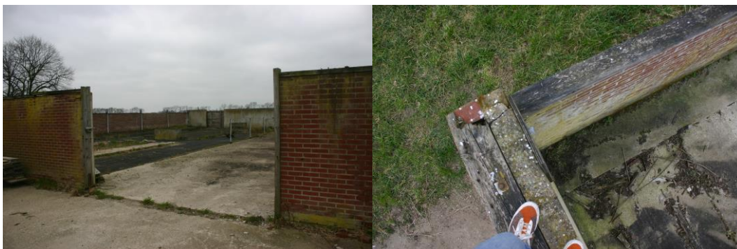
Figuur 4.4.2. De vervallen varkensstal bevat geen dak en de spouw is voor vleermuizen niet bereikbaar.
