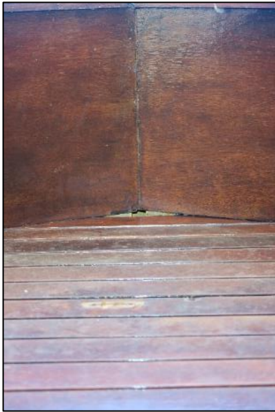
Foto 5. Opening onder het dak aan de noordwestzijde van de woning
