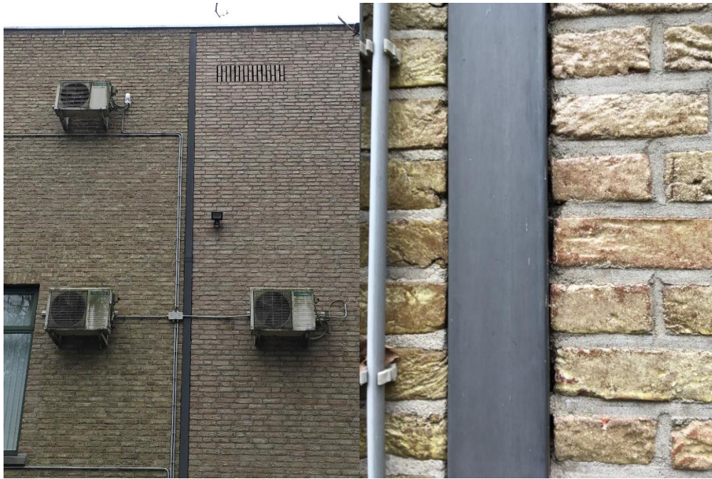
Figuur 3 De metalen stijl in de muur sluit niet goed aan, waardoor ook hier vleermuizen toegang hebben tot de spouw.
