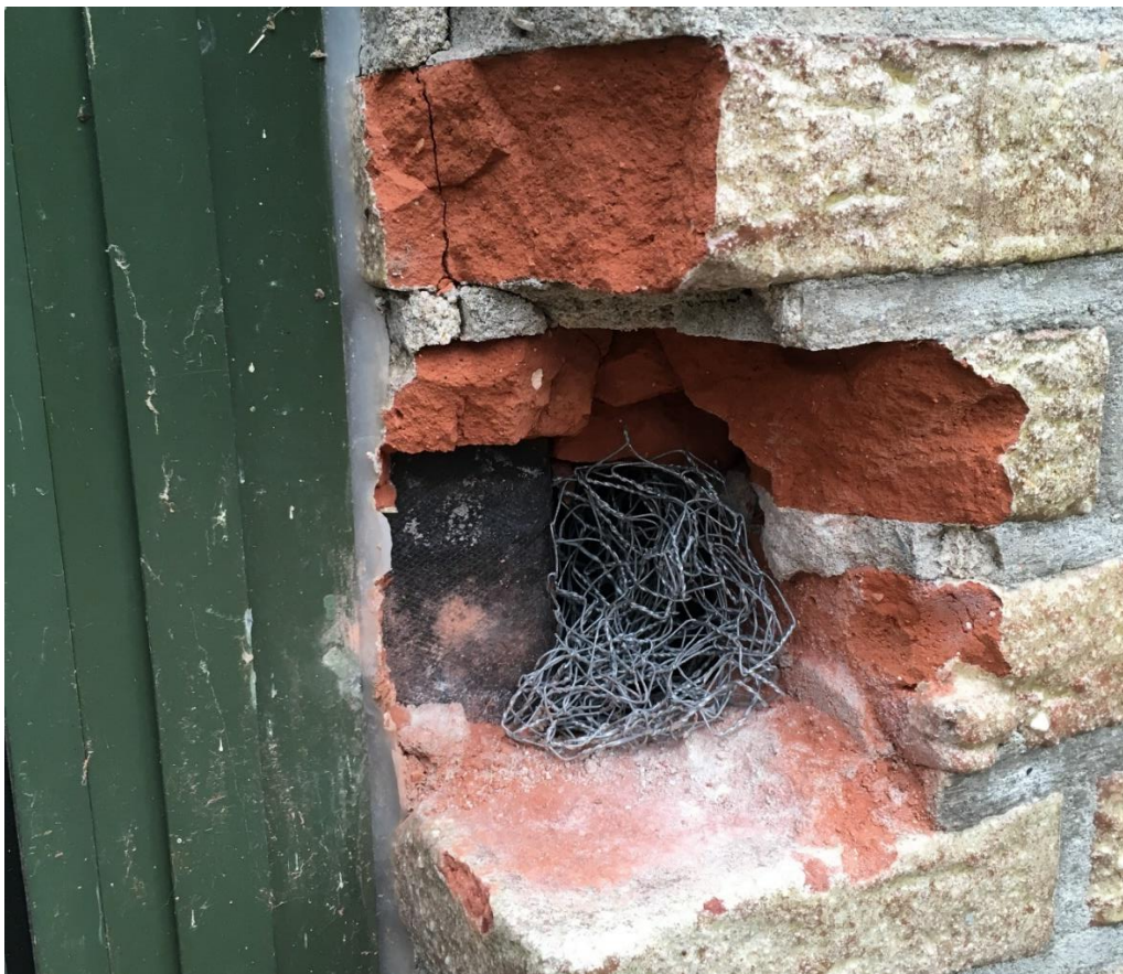
Figuur 4 In een gemaakte opening is goed te zien dat de spouw niet is geïsoleerd.
