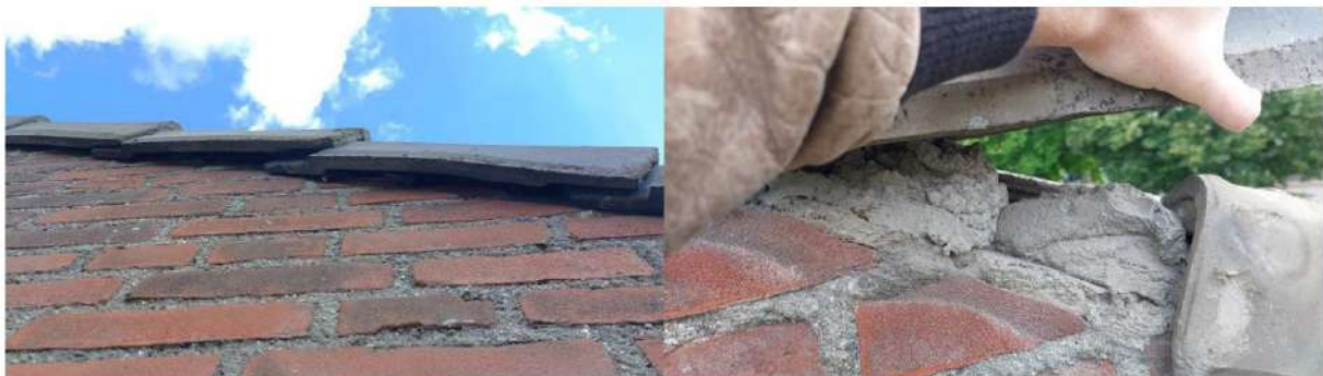
Figuur 4.4.2. Huismussen en gierzwaluwen kunnen niet onder de gevelpannen invliegen, maar vleermuizen zijn klein genoeg om tussen de niet gelijkmatig verdeelde specie door te kruipen.
