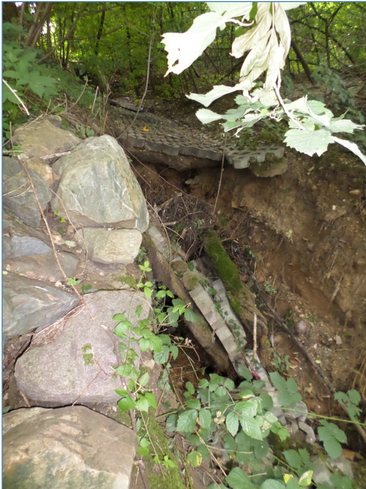
Foto 6 Erosieschade aan het einde van de overstort
