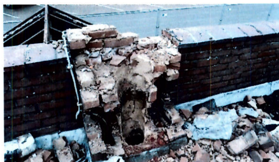
Foto 4: Rookgasafvoer zat los en is in zijn geheel gesaneerd.
