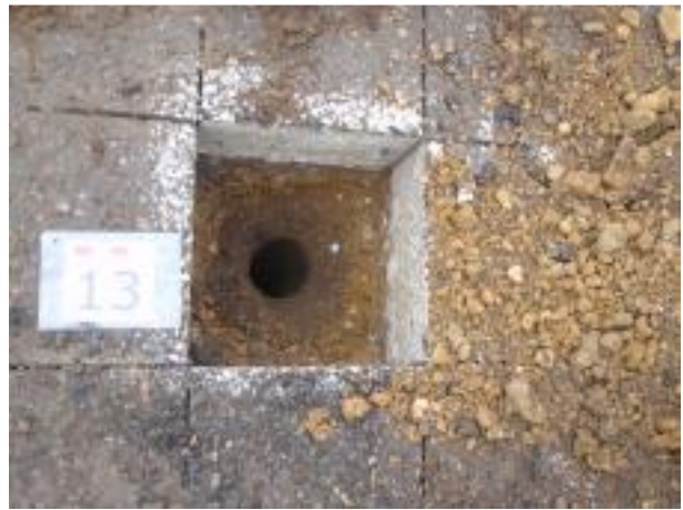
Foto 10: Voorbeeld van proefgat in asfalt. Voorbeeld van schone stol. Daaronder echter leem met kolengruis en puin tot 3,10 m-mv. Zie boorprofiel in bijlage IV.
