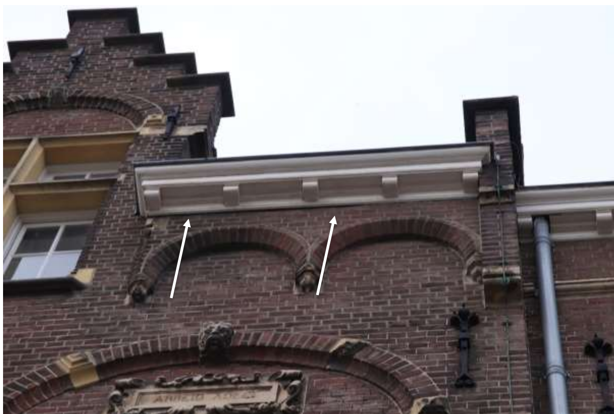
Foto 2: Witte bekisting onder de regengoot die op verschillende plekken openingen heeft
