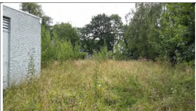
Fotonummer: 8 Omschrijving: Trafo op zuidelijke parkeerplaats
