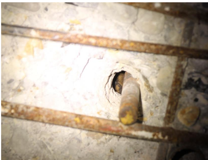
Foto 11: In diverse boorgaten in het plafond zaten vanaf 25 januari gewone dwergvleermuizen
