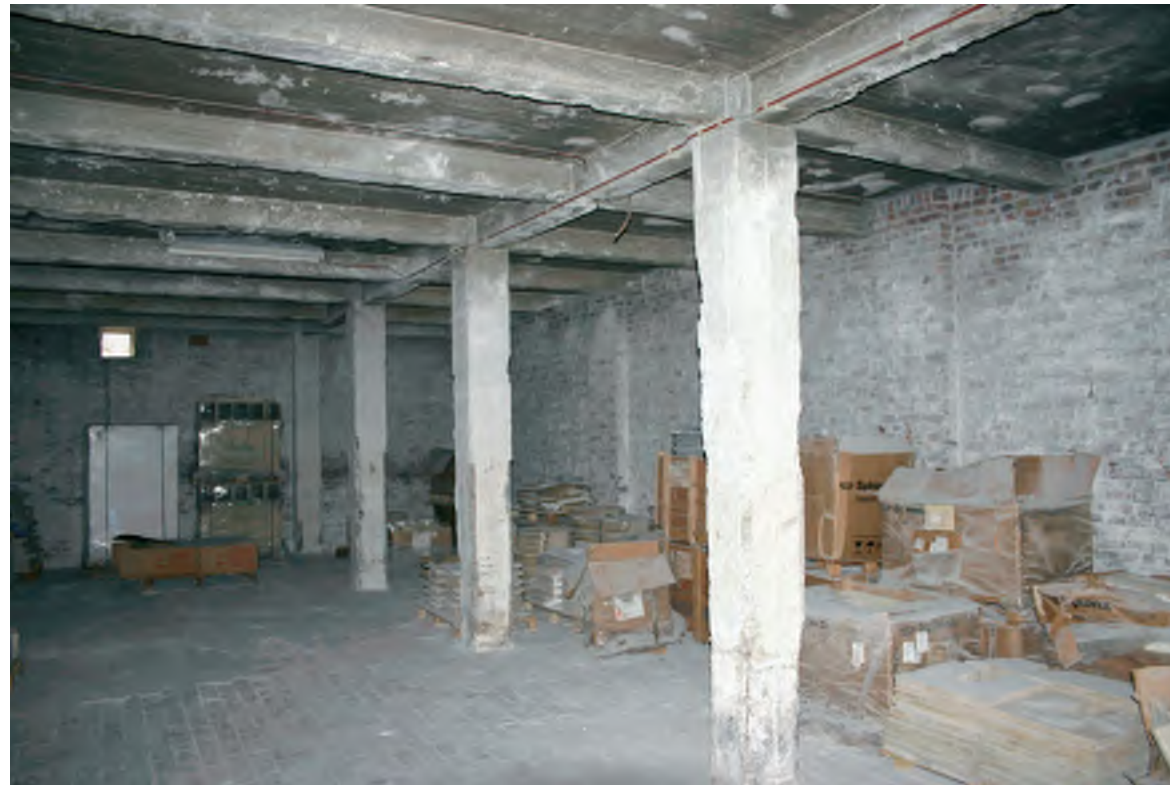
Afb. 118 Het sterk aangetaste betonskelet van het gebouw 34 gezien op de begane grond.
