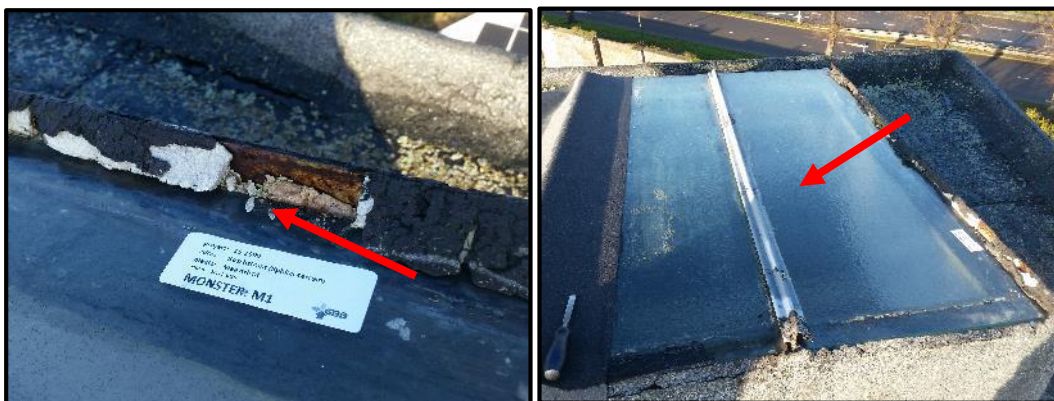
Bron 1/M1: stopverf lichtstraat, asbesthoudend.
