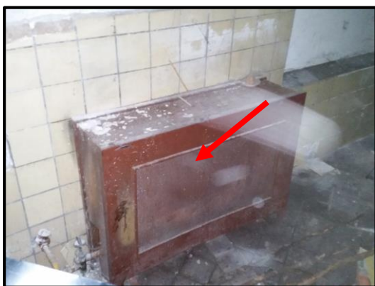
T2: kachel, asbestverdacht.
