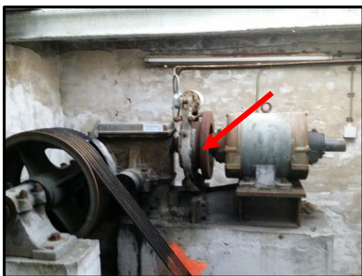
T1: liftinstallatie, asbesthoudend.
