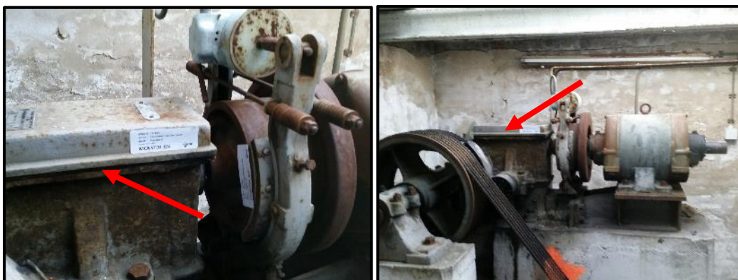
Bron 4/M4: koppakking liftinstallatie is asbesthoudend.
