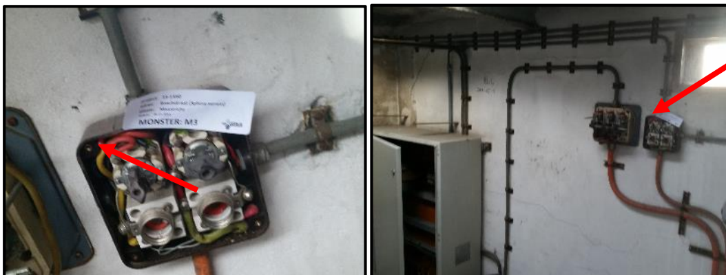
Bron 3/M3: bakeliet schakelmateriaal, asbesthoudend.
