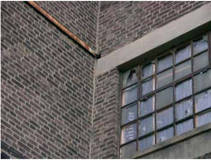
20. Om (verder) losscheuren te voorkomen is de koker met stalen banden verankerd aan het hoofdgebouw
