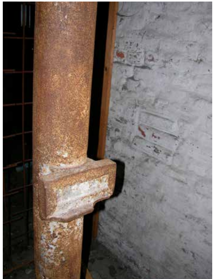
59. Op ongeveer 60 cm van de vloer heeft de kolom een zijbalkje
