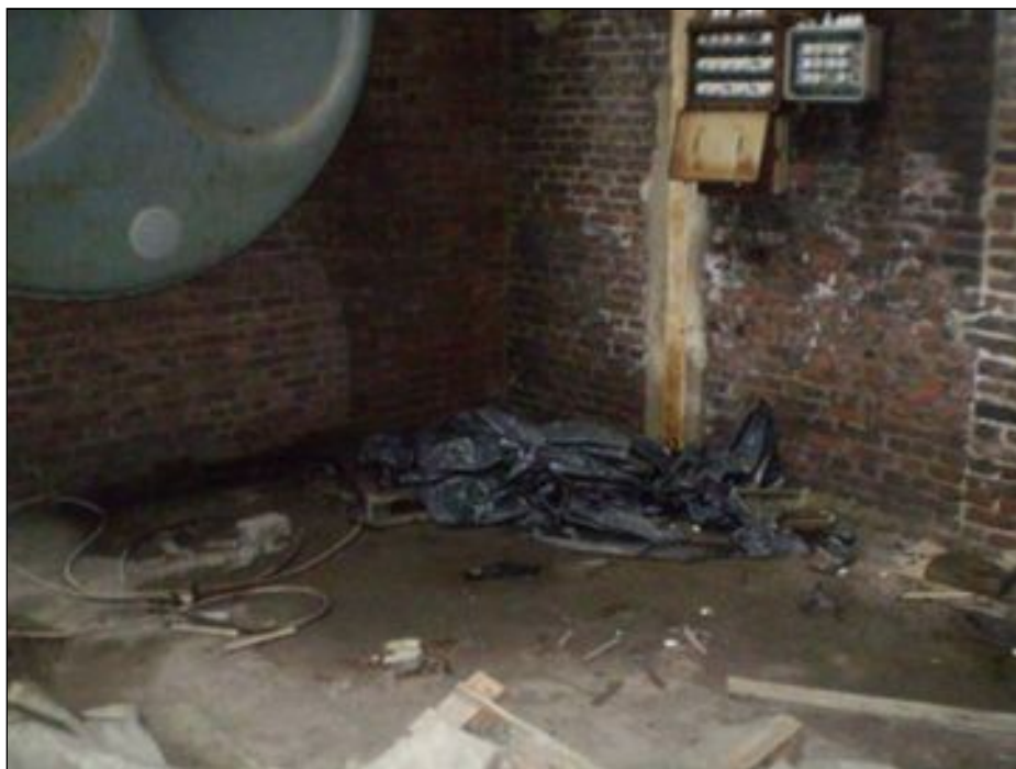
Foto 11. buffertank ter plaatse van ketelhuis
