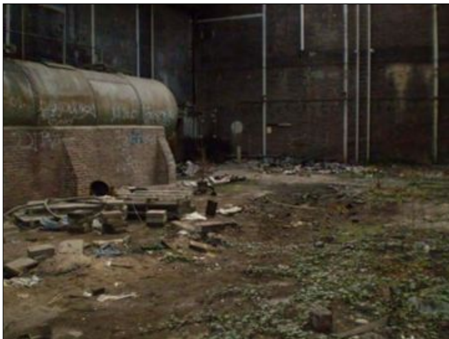
Foto 9. buffertank ter plaatse van ketelhuis
