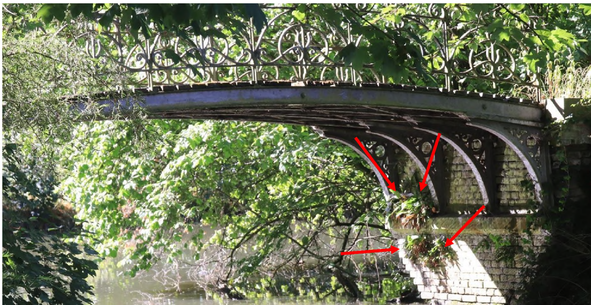
Foto 7: 4 tongvarens aan de onderzijde van de vijverbrug
