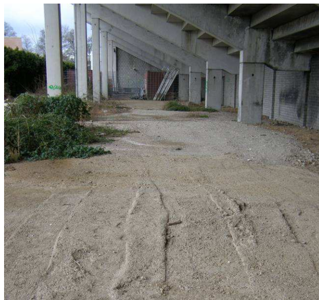
Fotonummer: 8 Omschrijving: Betonverharding onder tribune
