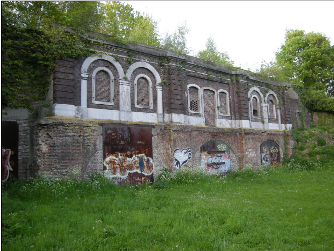
Figuur 7: recente foto van vervallen kazemat binnen de Lage Fronten.
