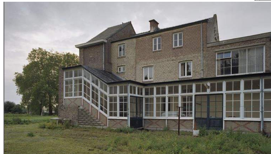
Zicht op het linker deel van de oostvleugels met de gang en trap naar de voormalige rectorwoning, uit de kloosterperiode (1880-1900). De technische staat van deze gang is momenteel slecht. Foto G. Dukker RCE 2004
